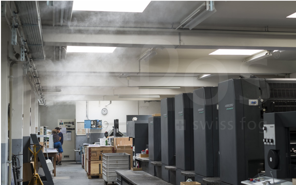
Nepos Fog-Anlage in der Tipografia Stazione in Locarno.
